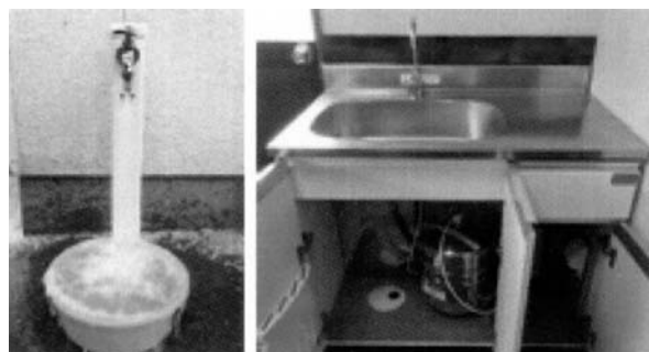
あかしまの家の屋外蛇口と屋内浄水装置(RO)
