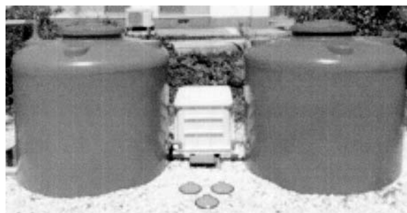
雨水タンク（6㎡：3㎡×2基）
